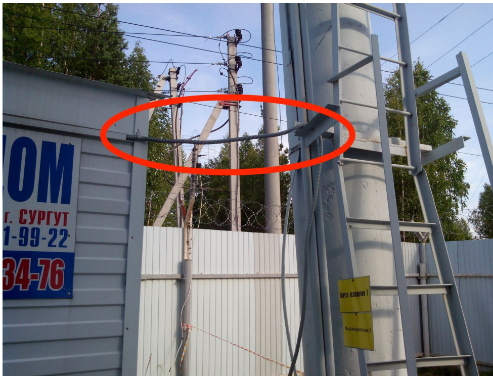
Рисунок 6 – Кабели с молниеотвода М8 в дом ДЭМ
