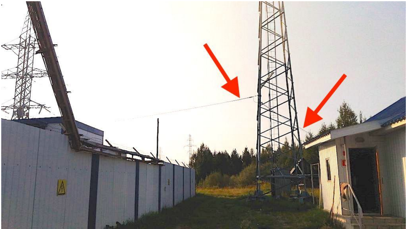
Рисунок 6 – Кабели с молниеотвода М2 в ОПУ-1 и дом ДЭМ
